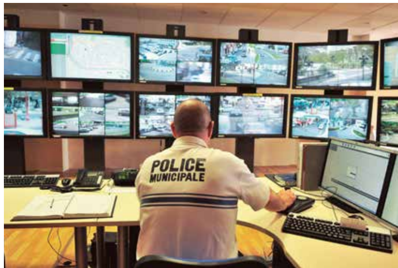
Depuis la salle de contrôle, les images fournies par les 140 caméras de vidéo protection sont analysées 24 heures sur 24 par les opérateurs formés à cet exercice.
