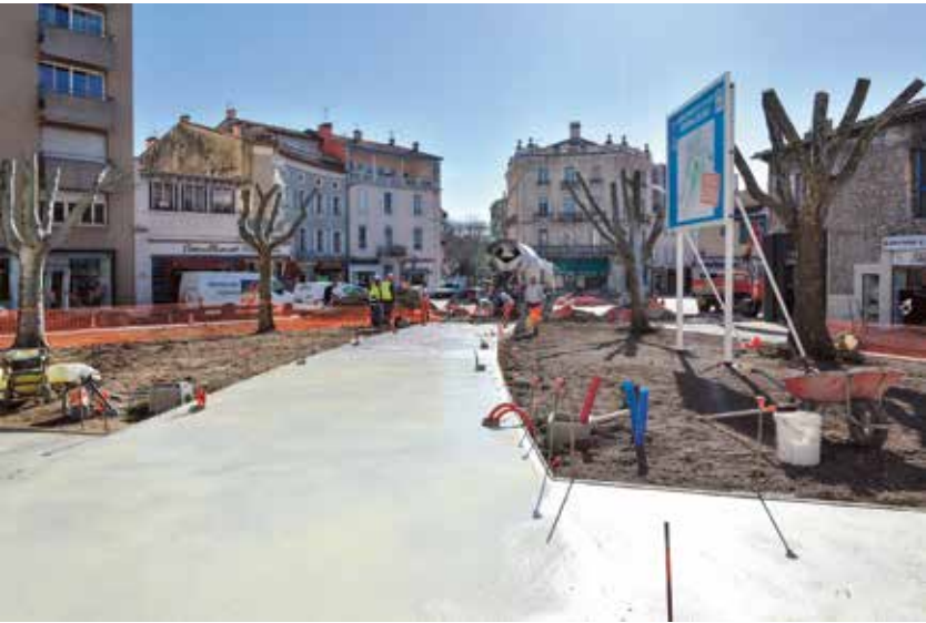
La sente piétonne descendra de la place des Martyrs jusqu'au cœur de ville via la place Leclerc totalement reconfigurée.
