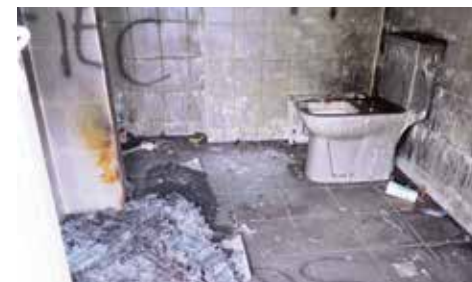
Les toilettes publiques ont été incendiées en février.
