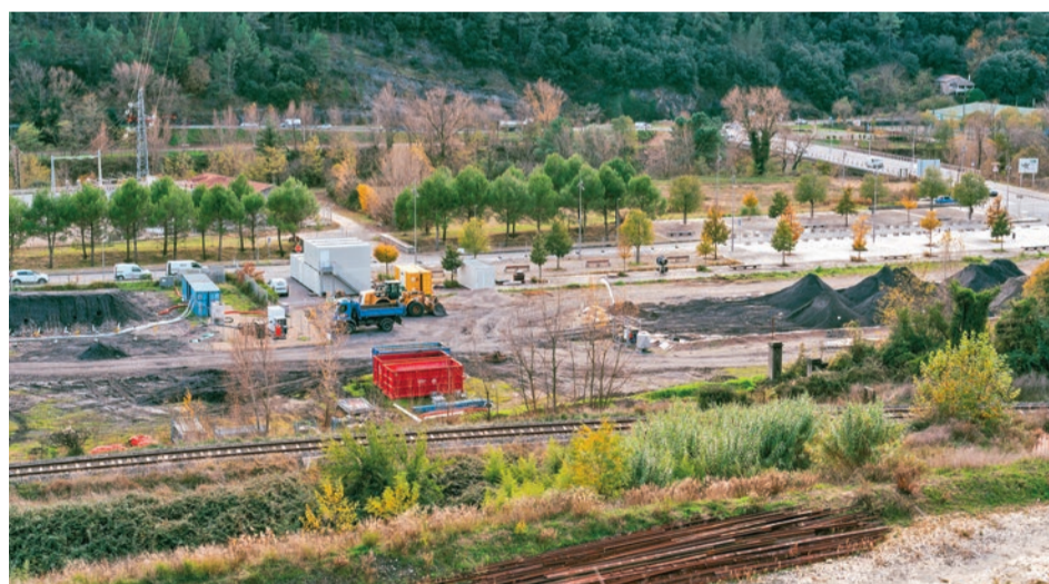
Les travaux de dépollution et d'aménagement des sols s'achèveront au début du printemps 2025. Le parc économique Humphry-Davy sera alors pleinement opérationnel.
