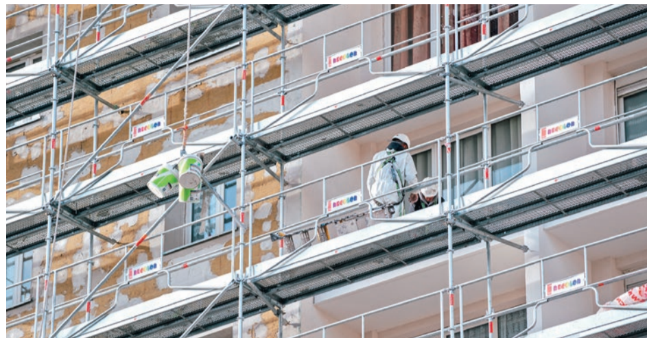
Pour gagner en efficacité énergétique, Logis Cévenols protège notamment ses logements avec une isolation thermique par l'extérieur.
