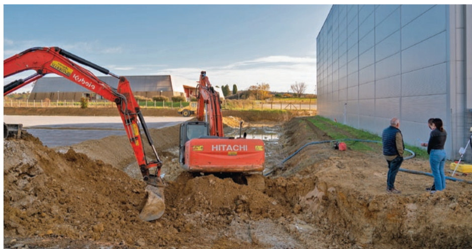
L'extension abritera notamment un immense espace de stockage, deux ateliers de conditionnement et des quais de chargement.
